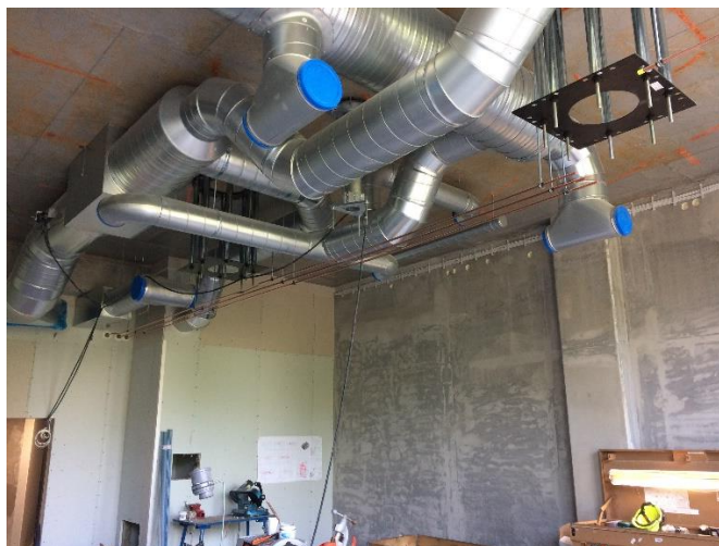
Forsyningssøjlels kompleksitet i forhold til øvrige rørføringer
