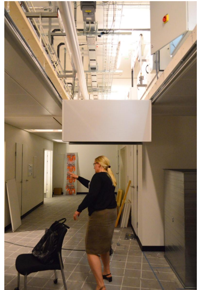
Gang midt i mock-up med adgang til teknik
