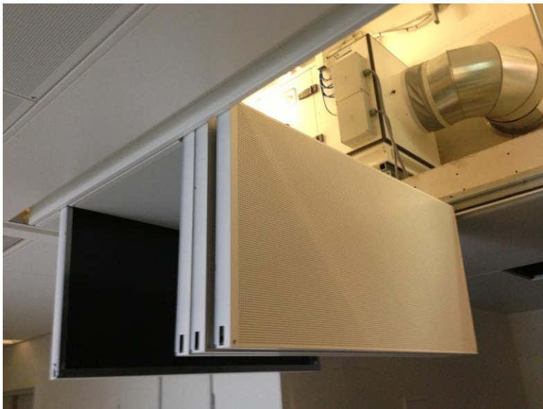
Ventilations aggregat på hylde
