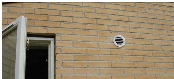
Friskluftsventil i facade
